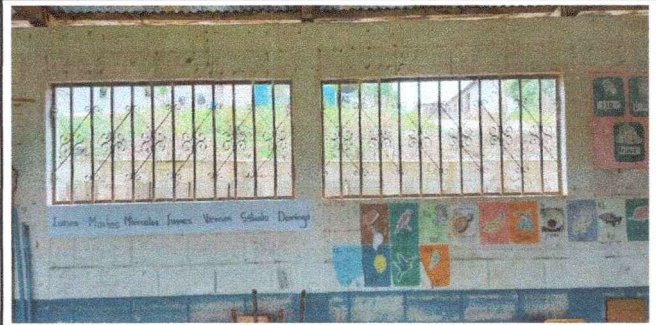
En esta fotografía demuestra la necesidad de cambio de 8 balcones del establecimiento.
